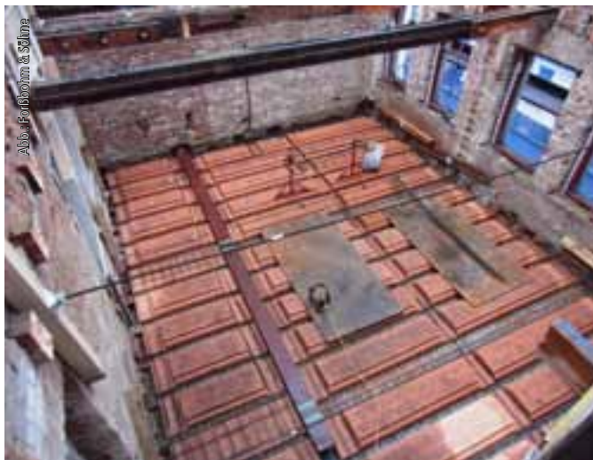
Abb. 4: Nur wenige Balken konnten erhalten werden. Deshalb wurden alle Decken mit einem Ziegelhandmontagesystem neu aufgebaut. Es ist leicht genug, um die Fundamente nicht zusätzlich zu belasten.
