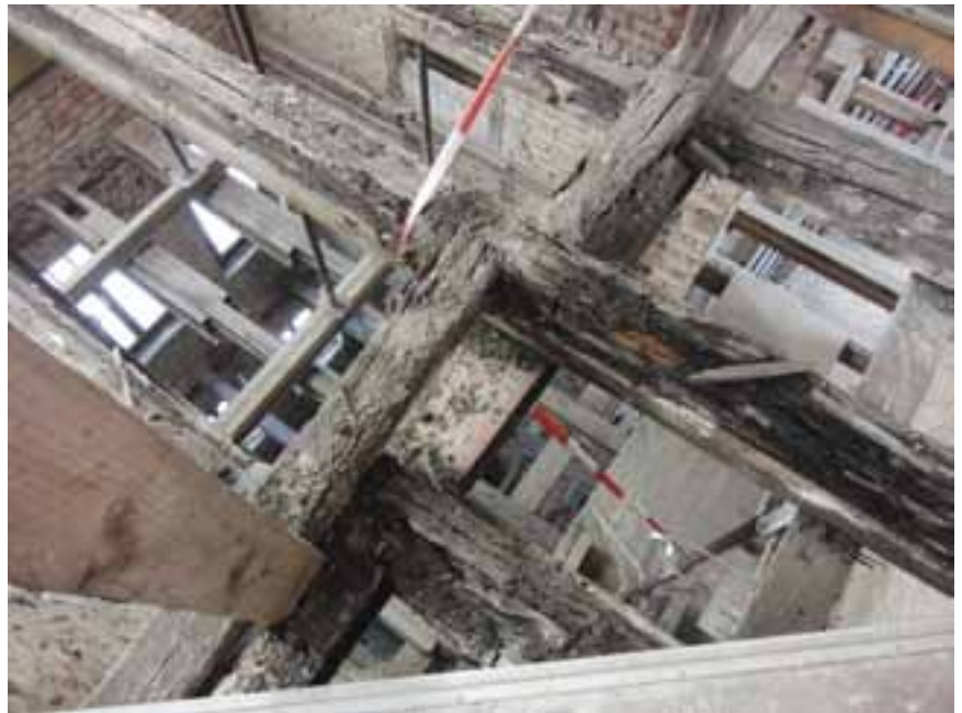
Abb. 3: Die alten Holzbalkendecken waren stark durchfeuchtet und geschädigt. Füllungen und Beläge wurden entfernt, um einen Einsturz der Decken zu verhindern.
